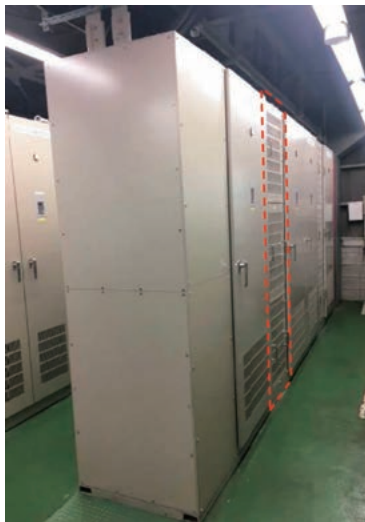
■ 図3 電気室 Fig.3 Panel room
