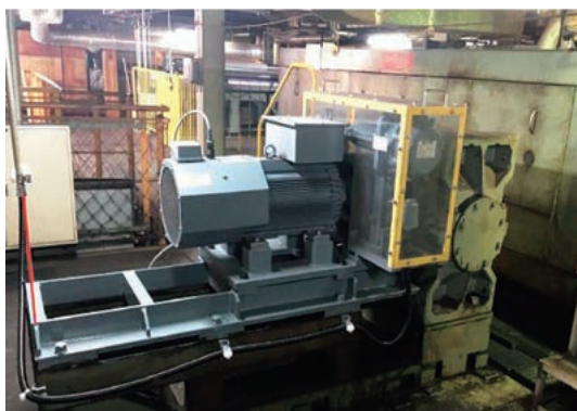
■ 図5 EDモータ設置状態 Fig.5 ED motor installation state
