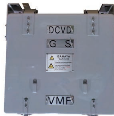
■ 図10 架線電圧検出器箱 Fig.10 Catenary voltage detector box
