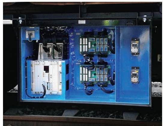
■ 戸閉制御切換装置
