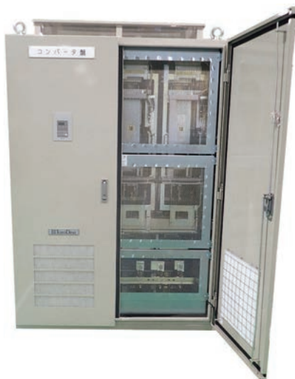
■ 図5 500kW正弦波コンバータ盤 Fig.5 500kW PWM sinusoidal wave converter
