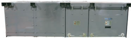
■ 図6 トランスフィルタ装置 Fig.6 Transformer and filter device
