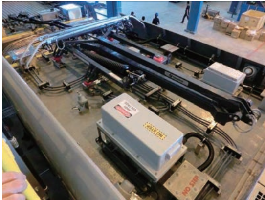
■ 図4 高速度遮断器ぎ装状態 Fig.4 Mounted condition of HSCB
