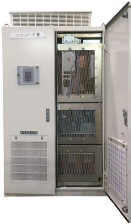
■ 図4 500kW 正弦波コンバータの外観 Fig.4 Appearance of 500kW sinusoidal wave converter
