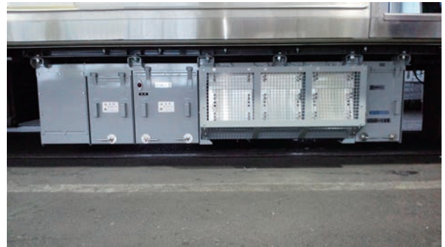
■ 図3 インバータ装置外観 Fig.3 Static inverter
