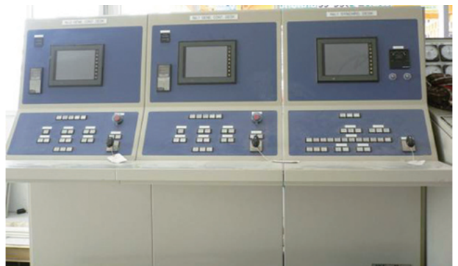
■ 図2 発電機制御デスク及び同期デスク Fig.2 Generator Control Desk and Synchro. Desk
