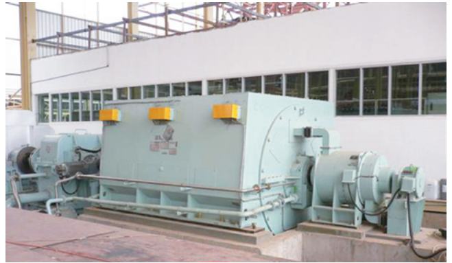
■ 図1 25 MW 発電機 Fig.1 25MW Generator
