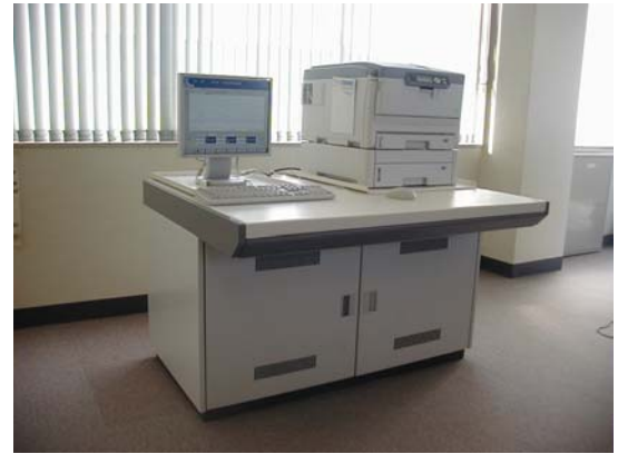
図2 水質監視装置
