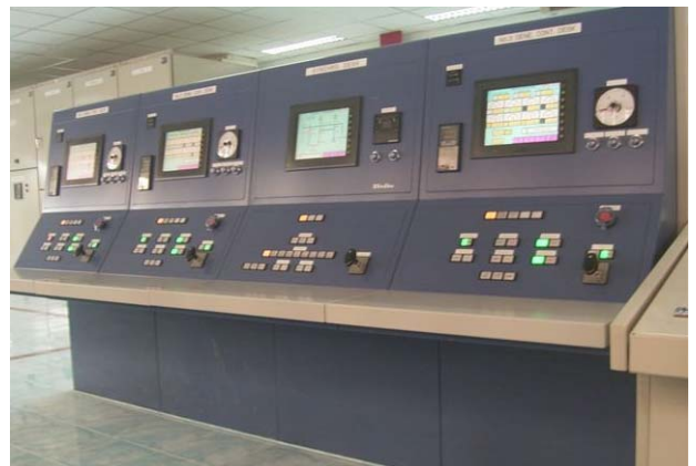
図3 発電機制御デスクと同期デスク Fig.3 Generator Control Desk and Synchro. Desk
