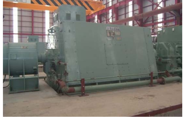
図1 発電機 Fig.1 Generator
