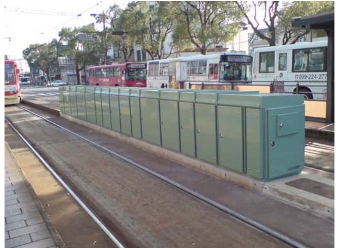
図1 架線電圧補償システム外観
