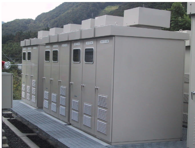
電力補完装置
