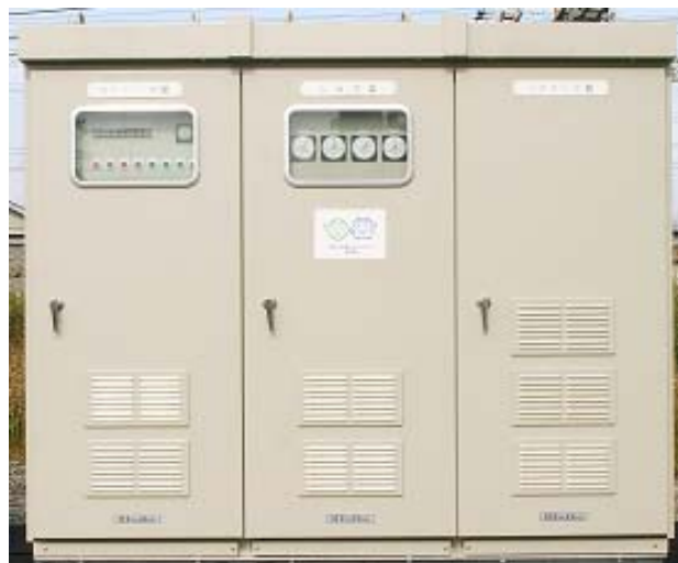
蓄電システム
