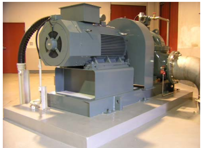
図1 増圧ポンプと200kW EDモータ Fig.1 Booster pump and 200kW EDmotor
