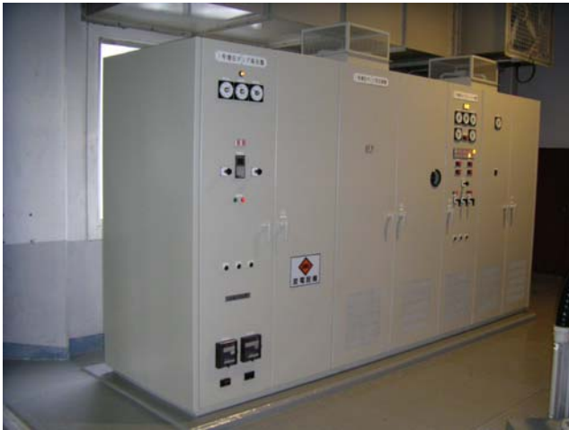
図2 増圧ポンプ盤
