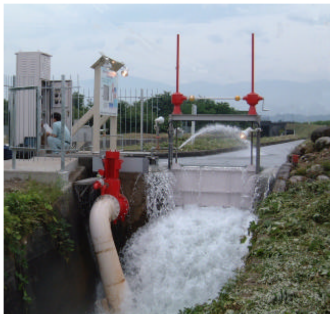
図1 農業用水落差利用ミニ水力発電実証試験整備全景
