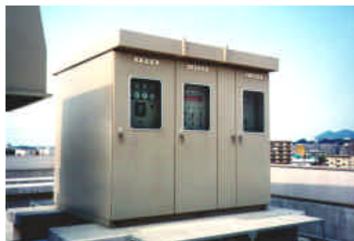
発電機制御盤
