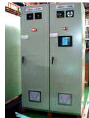
自動監視記録装置
