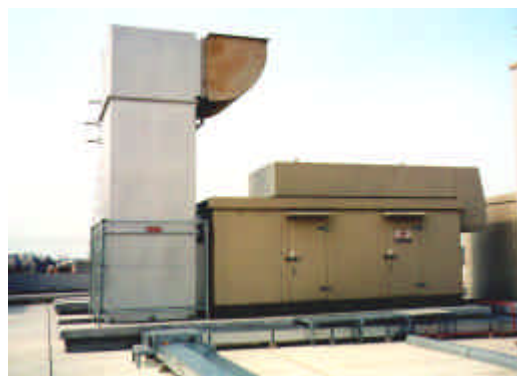
発電機パッケージ
