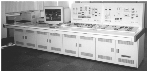
監視室 中央監視設備
