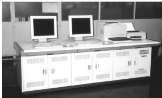
監視ログ設備外観
