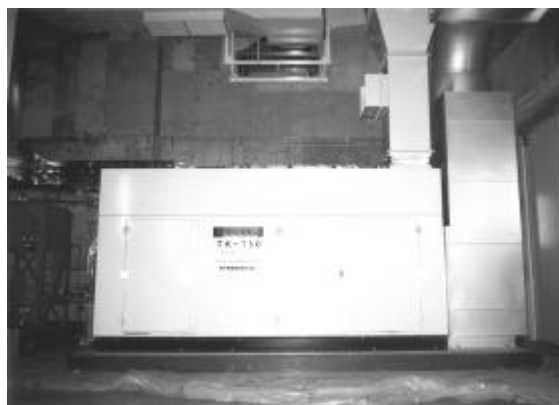
発電機パッケージ
