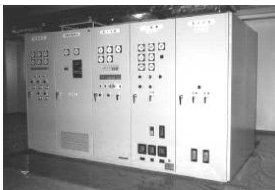
発電機制御盤
