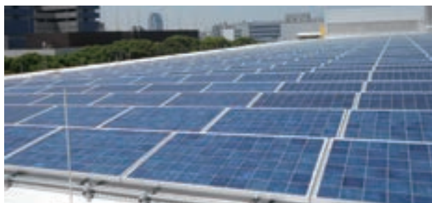
横浜製作所の太陽光発電システム
