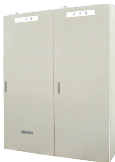
高速電源切替装置収納制御盤
