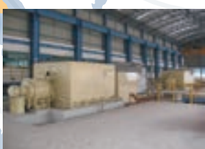
バイオマス発電システム 生物发电系统
