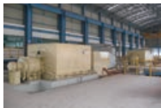
バイオマス発電システム 生物发电系统
