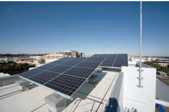
太陽光発電装置（2010年 横浜製作所エンジニアリングセンター屋上）
