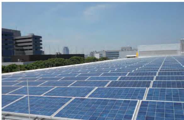
太陽光発電システム（2012年 横浜製作所工場棟屋上）
