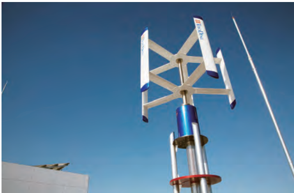
風力発電装置（2010年 横浜製作所エンジニアリングセンター屋上）
