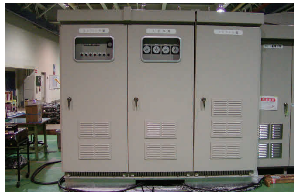
鉄道用電力貯蔵システム試作機 (2006年 JR西日本納入)
