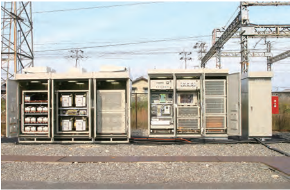
鉄道用電力貯蔵装置「E³ Solution System」(2006年)
