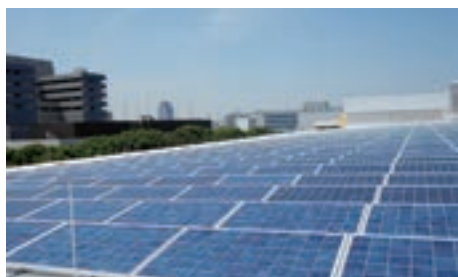
横浜製作所 太陽光発電システム
