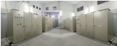
東武鉄道株式会社 東上線・上福岡駅電区分所
