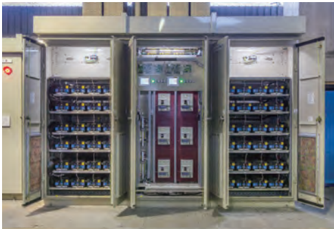
多摩都市モノレール株式会社 日野変電所
